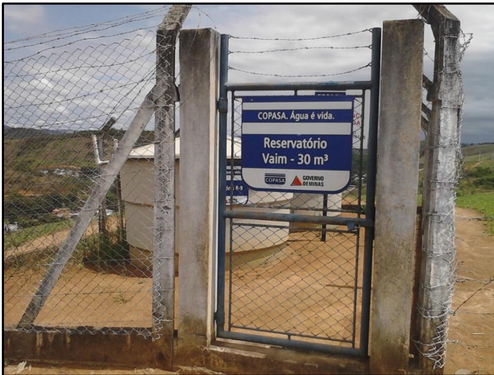
Figura 43 – Reservatórios RAP-09 / RAP-10 – Apoiado com capacidade: 30 m 3 (Abastece o bairro São Sebastião)
