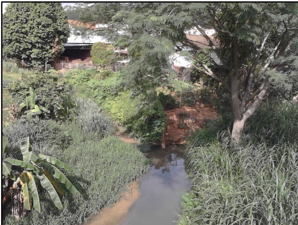
Figura 79 – Margens necessitando um tratamento adequado.
