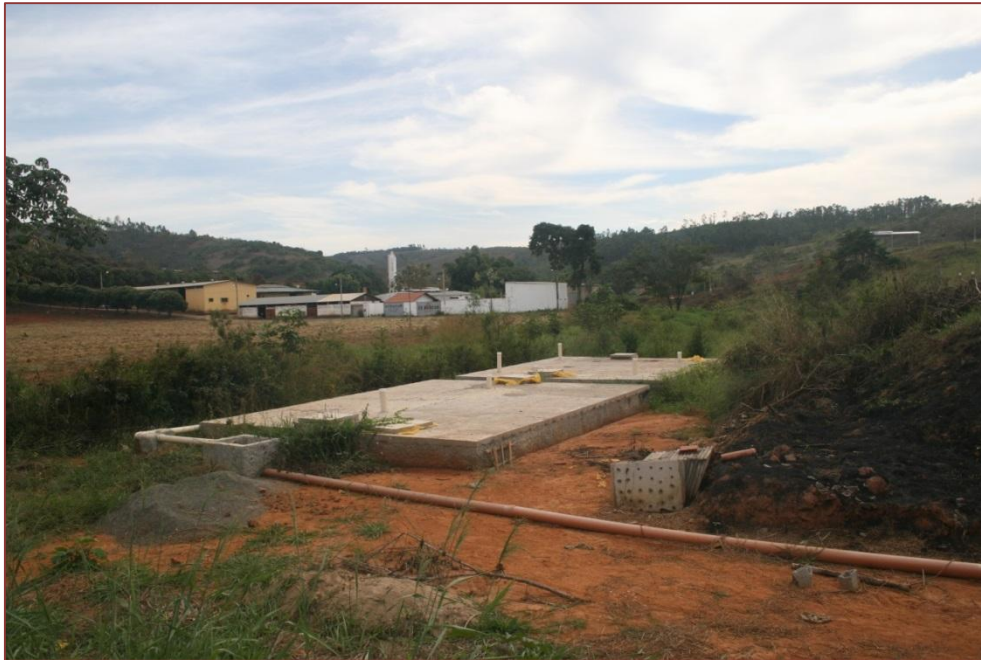
Figura 47 - ETE tipo fossa séptica seguida de filtro anaeróbico do bairro Vale do Ipê.
