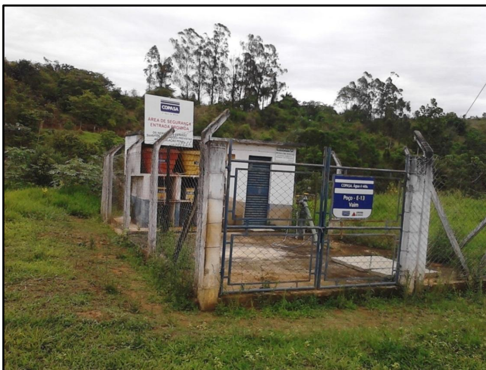
Figura 36 - Poço E-13 (Vaim) que abastece o Bairro São Sebastião
