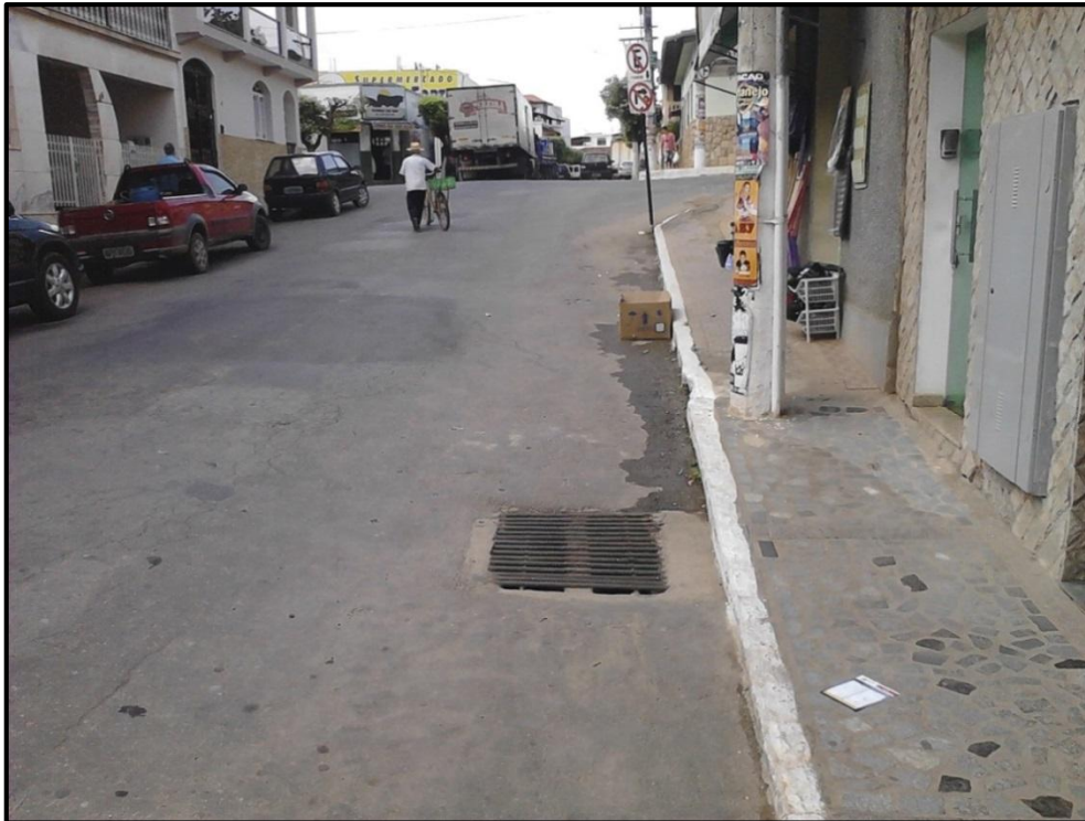
Figura 73 – Boca de lobo com barras de ferro
