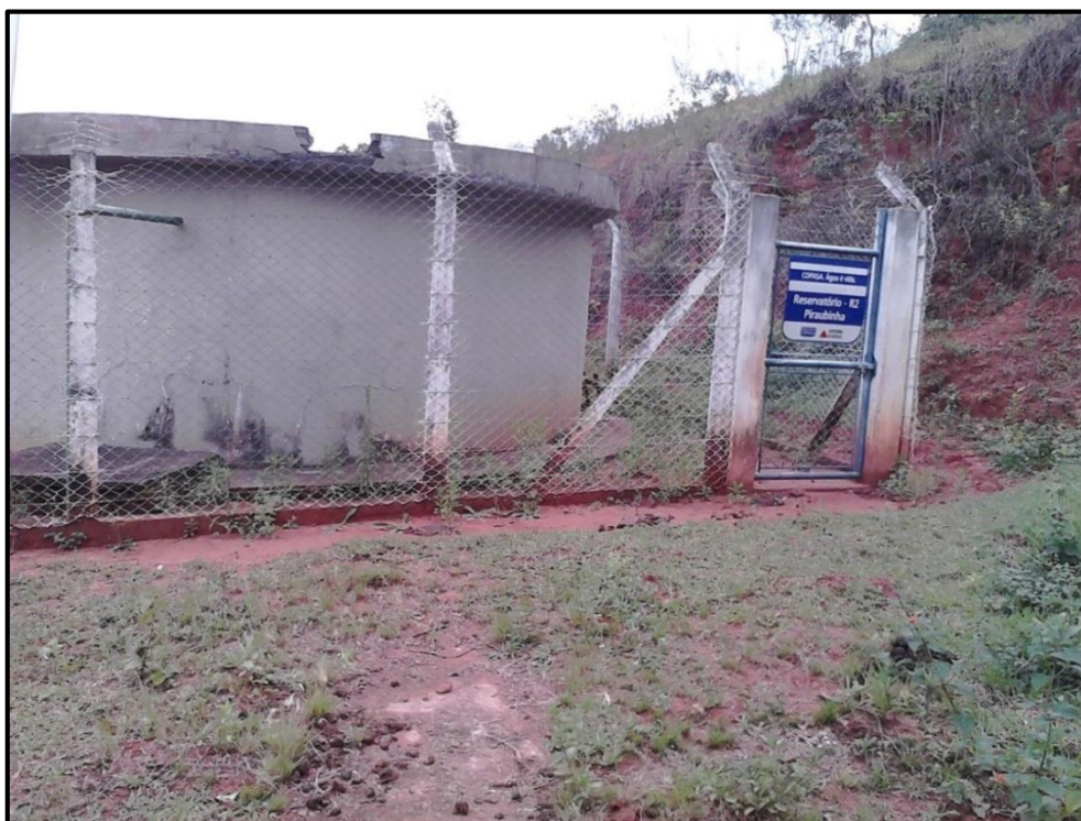
Figura 40 - Reservatório RAP-08 – Apoiado de concreto com capacidade: 150 m 3 (Abastece os bairros Piraubinha e Santa Terezinha)
