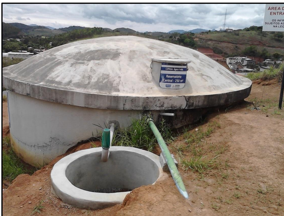
Figura 39 - Reservatório Central RAP-01, de concreto apoiado com capacidade: 250 m 3
