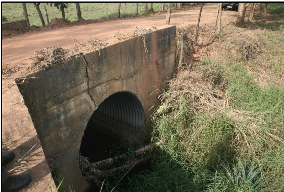
Figura 77 – Galeria que foi modificada no bairro Granja Aurimar para eliminar ocorrência de enchentes.
