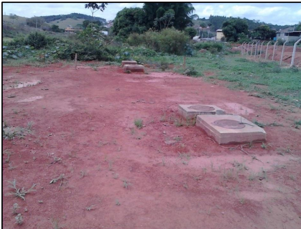
Figura 51 - ETE do distrito industrial, enterrada do tipo fossa séptica coletiva seguida de filtro anaeróbico, necessitando uma melhor manutenção.
