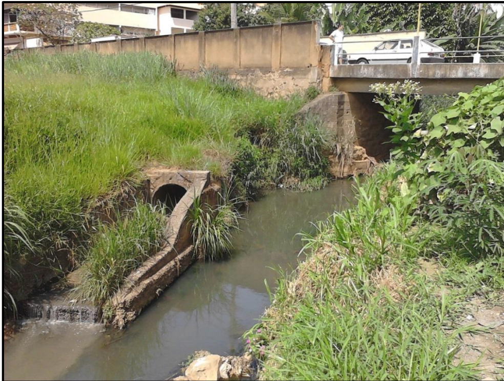
Figura 78 – Esgoto domestico sem tratamento sendo lançado no ribeirão Piraúba.
