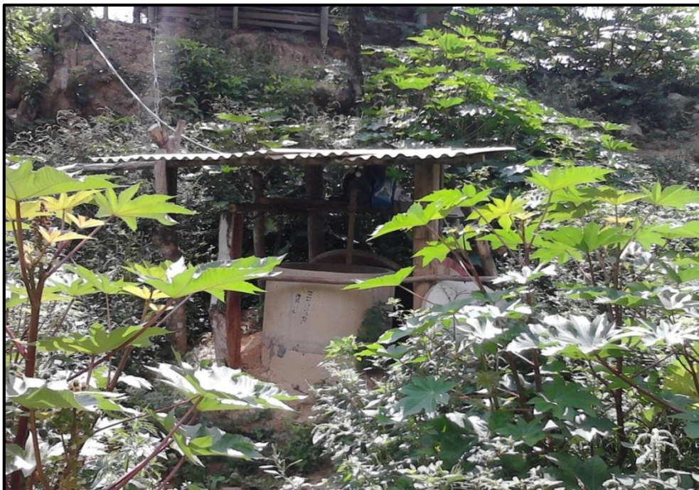
Figura 44 – Sistema de água particular utilizando cisterna para captar água do lençol freático
