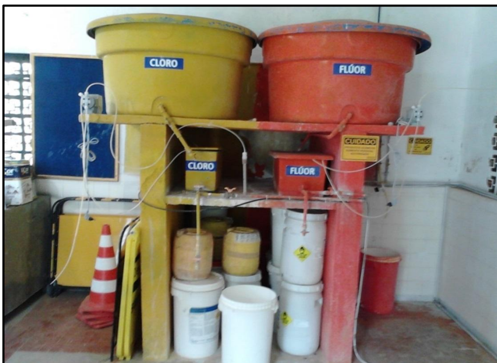
Figura 31- Local onde são dosados o cloro (hipoclorito de sódio) e flúor (ácido fluossilícico)
