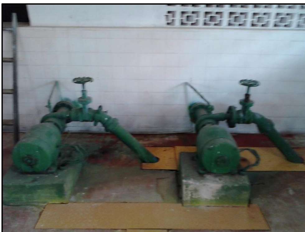
Figura 32 - Bombas centrífugas responsáveis por recalcar a água tratada do tanque de contato para a cidade.
