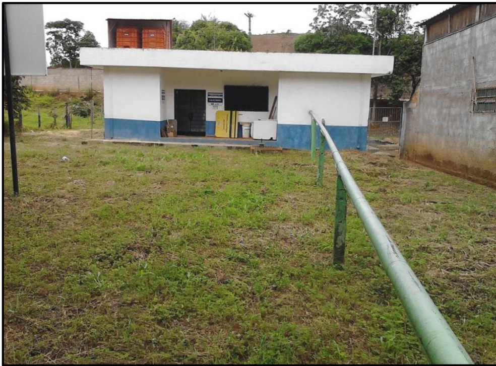
Figura 30 - Tanque de Contato, onde são dosados cloro e flúor, e a água é recalçada para a parte central da cidade.
