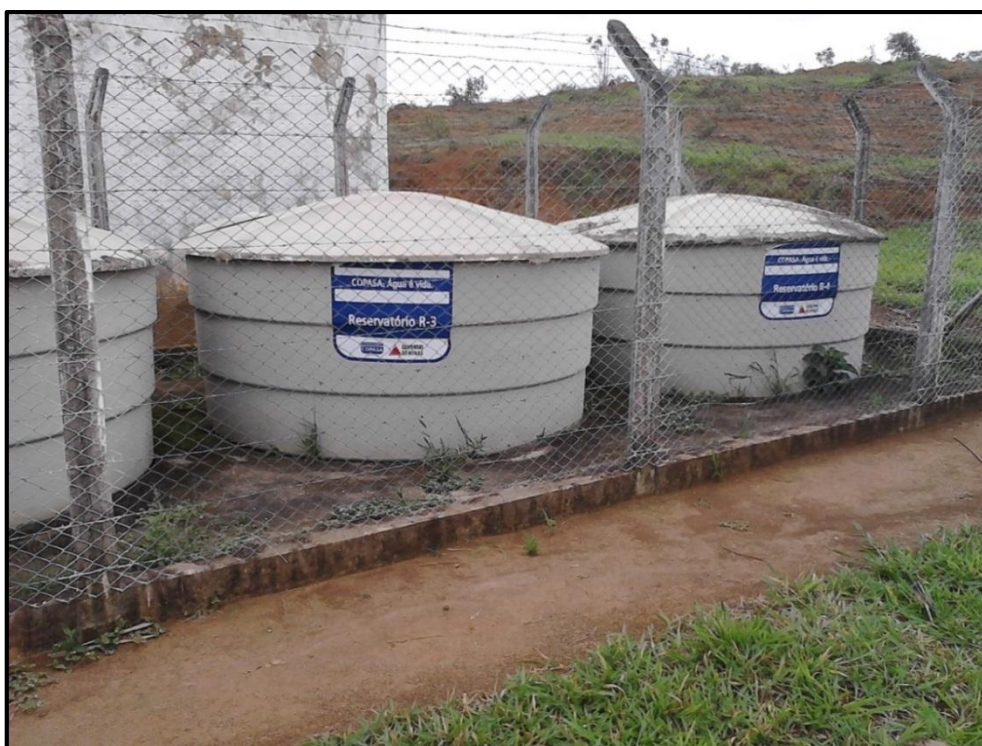
Figura 42 - Reservatórios RAP-02 / RAP-03 / RAP-04 – Apoiado com capacidade: 45 m 3 (Abastece os bairros João Gonçalves da Neiva e Sossego)
