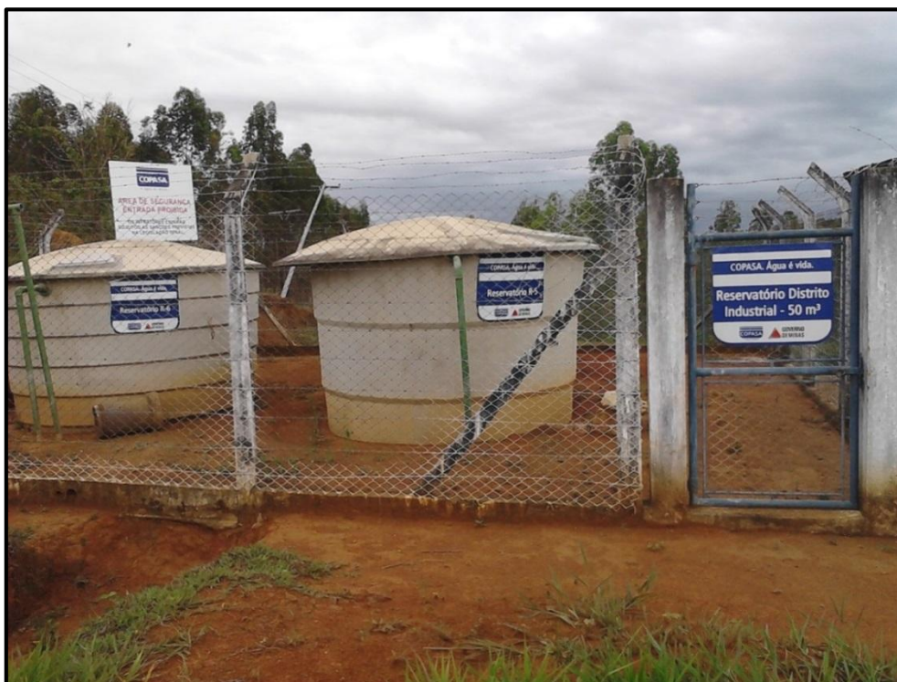
Figura 41 - Reservatórios RAP-05 / RAP-06 / RAP-07 – Apoiado com capacidade: 50 m 3 (Abastece os bairros João Gonçalves Neiva e Distrito Industrial/Parte Alta)
