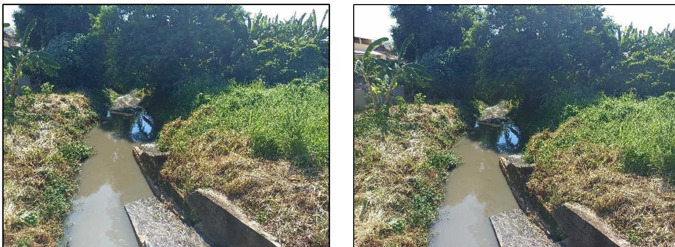
Figura 67 - Macrodrenagem em Piraúba.
