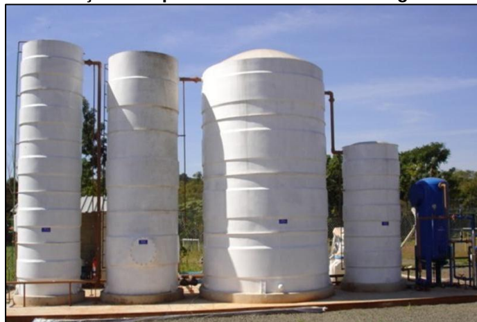
Figura 79 – Estação Compacta de Tratamento de Esgotos Sanitários.
