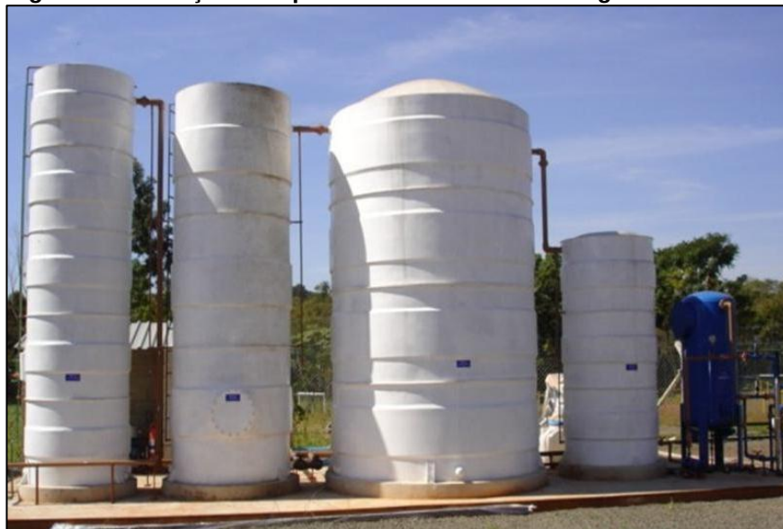
Figura 32 – Estação Compacta de Tratamento de Esgotos Sanitários.
