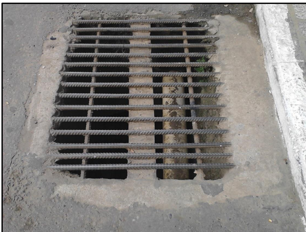
Figura 74 – Detalhe do tipo de boca de lobo.
